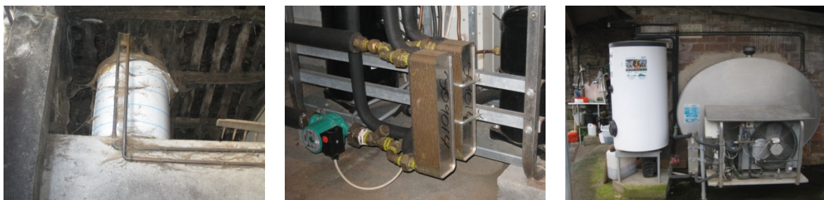
Fotografía 3- Intercambiador de calor
